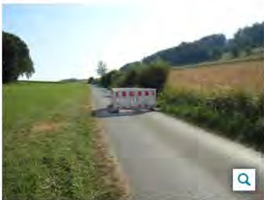
Maroder Wirtschaftsweg in Garbeck: Er ist inzwischen wieder repariert, Foto: Stadt Balve
